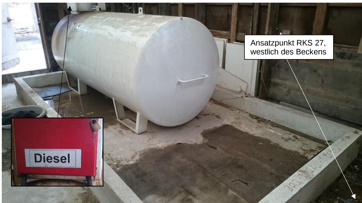
Bild 6: Dieseltank in der südöstlichen Ecke der Halle (RKS 27)
